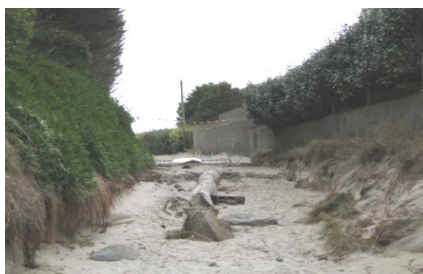
Au Billou, la mer s'est engouffrée dans le chemin d'accès à la plage, laissant apparaître le tuyau d'évacuation des eaux pluviales.
